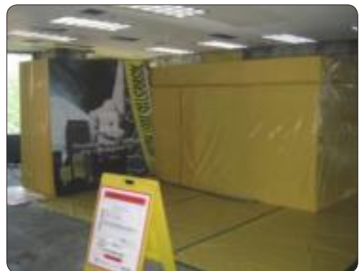
[그림 10-7] 위생설비 측면에 설치한 석면폐기물 반출구 예시
